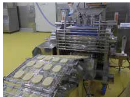
メンチ・コロケライン 2階の精肉加工のプロセスセンターは、豚肉・鶏肉などを5℃管理下で製造。グループとして初めての惣菜と精肉が一体化した工場、弁当等の商品開発を進めていく。たれの内製化も進め、活用した商品化も進める。
