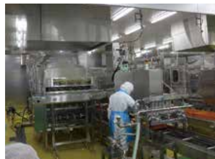
ピースデリ千葉キッチン ポテトふかし器設備 1階の惣菜製造のセントラルキッチンでは、野菜を丸のまま入荷、洗浄・カットする。
